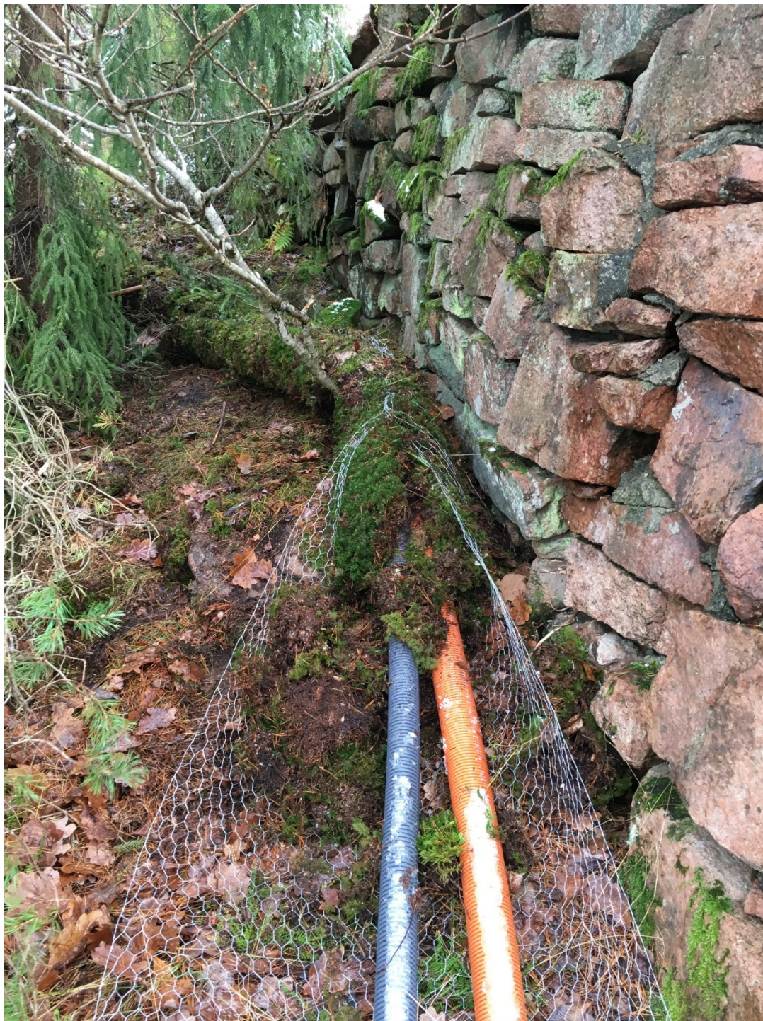
Figur 3: Figuren viser teknikken entreprenøren benytter for å skjule ledninger lagt over fjell
